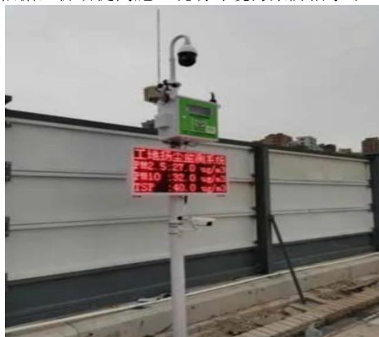
图2 工地扬尘监测系统
